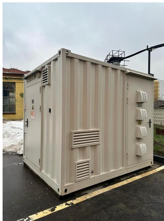
Рисунок 2 – Контейнер с системой хранения электроэнергии (с сайта https://www.rlocman.ru/news )
