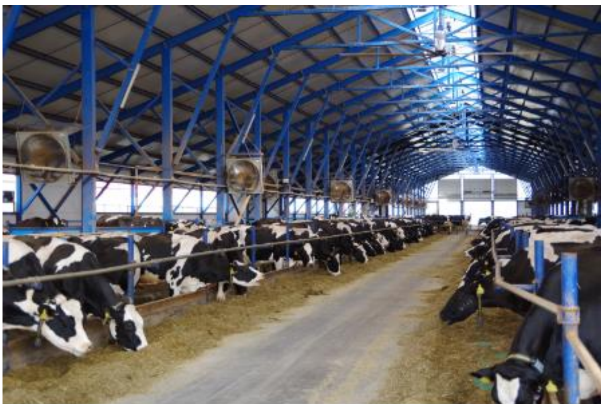
Рисунок 1 - Размещение разгонных вентиляторов в коровнике [4]
