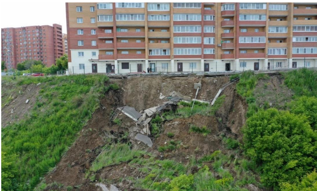
Рисунок 3 - Разрушение придомовой территории в результате просадки грунта (2025 год) [с сайта https://ngs24.ru/text/gorod/2025/08/13/75819245/ ]
