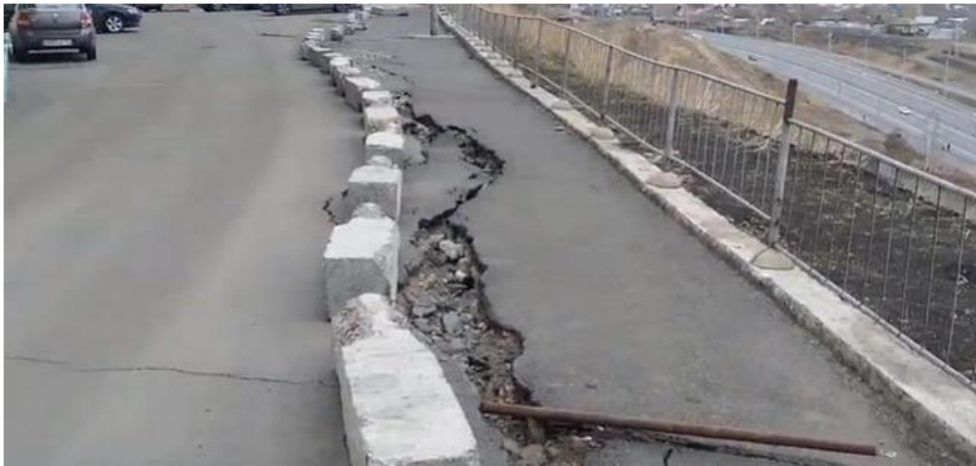
Рисунок 1 - Трещины на придомовой территории, свидетельствующие о подвижках грунта [с сайта https://ngs24.ru/text/realty/2019/05/02/66076099/ ]
