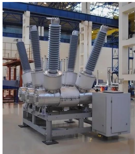
Рисунок 3 - Выключатель элегазовый ВЭБ-110-40-2500
